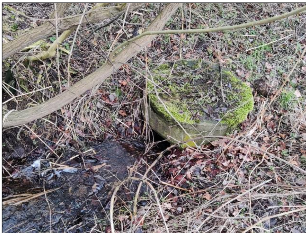
Figur 11: Overløbsbrønd i afvandingssystem 7.
