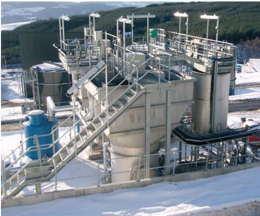
Figur 15 Eksempel på installation af et lamel sedimentering (Actiflo®), Loch Turret Vandværk
