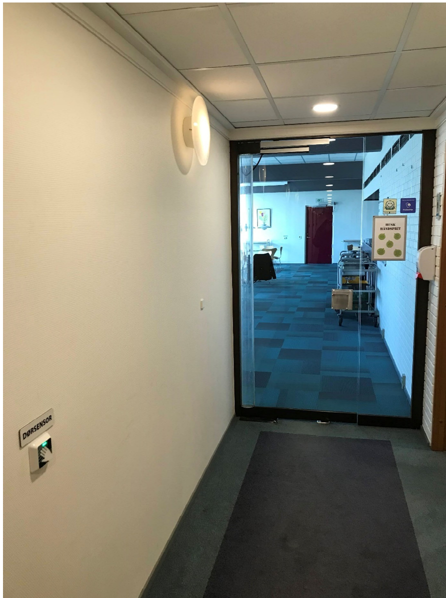
Figur 4.2 Motoriseret dør på rådhuset i Otterup. Berøringsfri sensor ses i venstre side.
