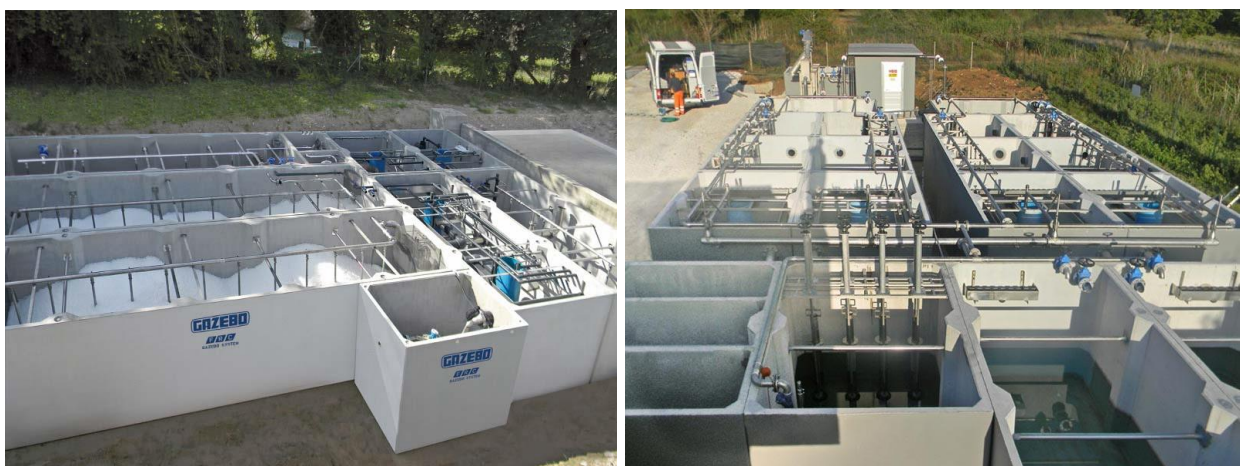
Figur 23 Eksempel på et fuldskala kompakt MBBR anlæg fra italiensk leverandør (Gazebo) før tilledning af spildevand
