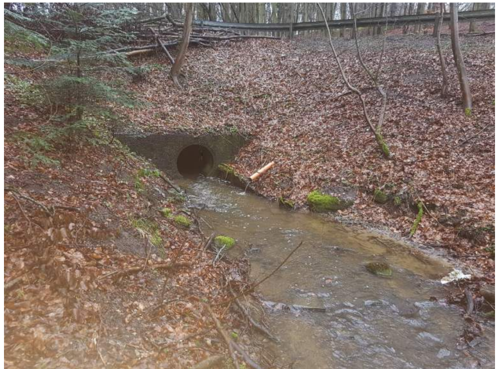
Figur 4-5 ODE-3021 ved Travn Skov Afløbets passage under Søndersøvej
